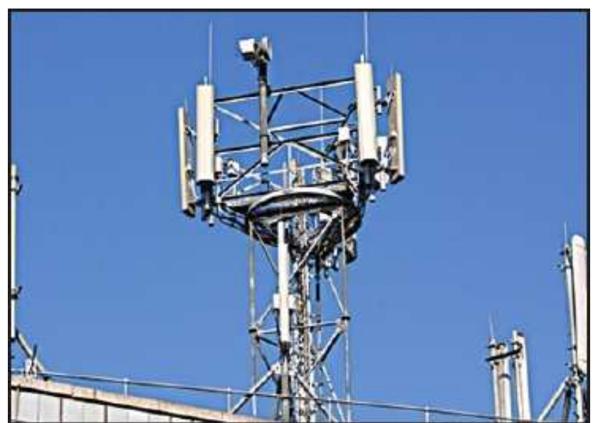
Figura 14 - Estação de rádio base.
